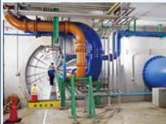
沈砂池管理棟と水処理施設をつなぐ地下管廊
